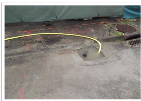
[Traitement des eaux]
